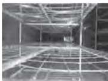
لوله گالوانیزه یا کف طناب کشی شده
